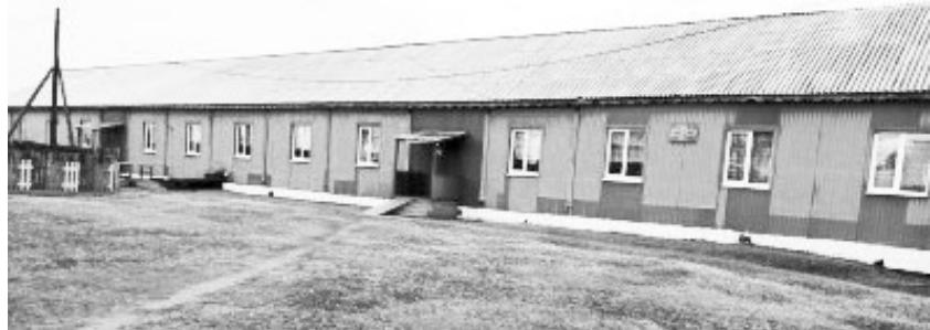
Верхнекодунская СОШ. До ремонта
